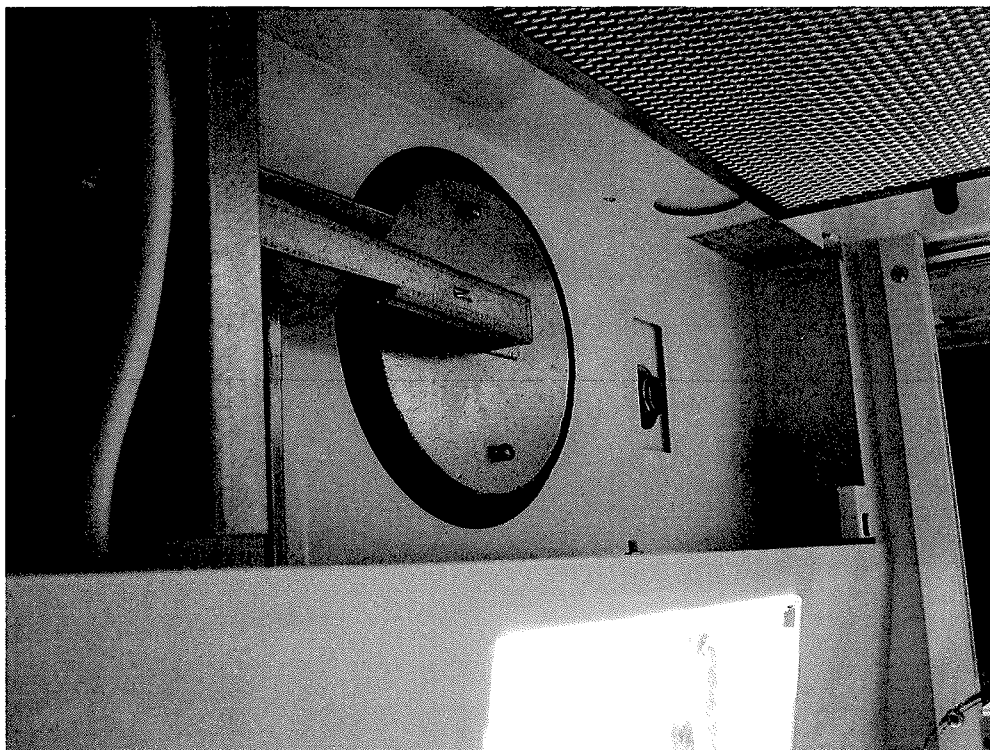
Abb. 2: Dunstabzugshaube; geschlossene Absperrklappe
