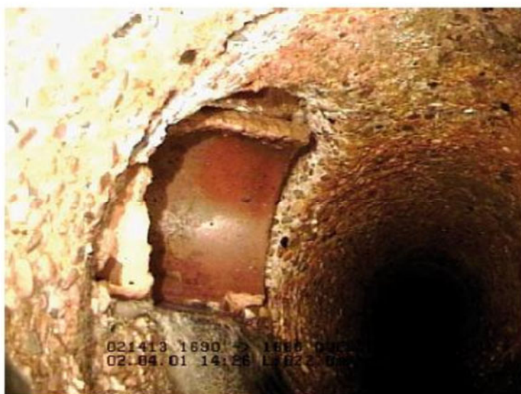
Foto einer Schadstelle
