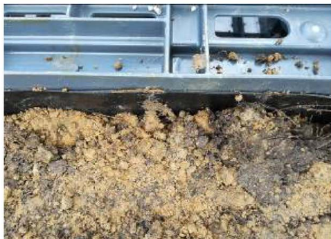
Abbildung 6: eingebaute D-Rainclean Box mit seitlicher Folienumrandung
